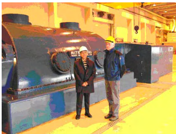
写真19 Krafla 発電所30MW タービン
