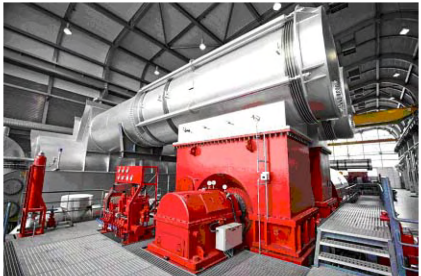
写真13 Reykjanes 発電所 50MW タービン
